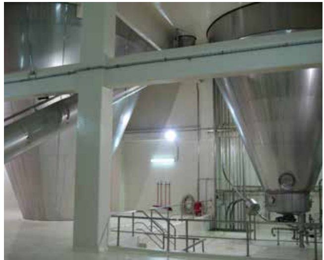
Sektion einer Milchtrocknungsanlage – Konus einer Trockenkammer und Unterteil eines Schlauchfilters
